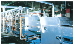
タッピングネジ・ボルトの無酸化焼入設備（ガス焚）
