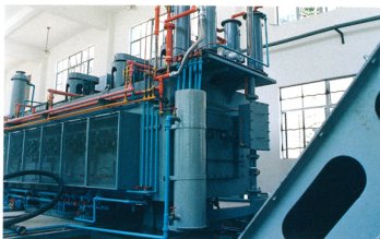
ヒュームガス再利用システム実例
