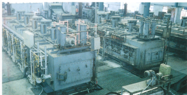
1200kg/Hw連続浸炭焼入・焼戻設備
