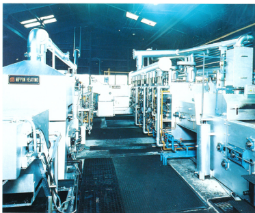
タッピングネジ・ボルトの焼入・焼戻 (ガス焚)
