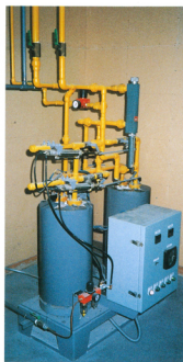
アンモニア分解ガス精製装置
